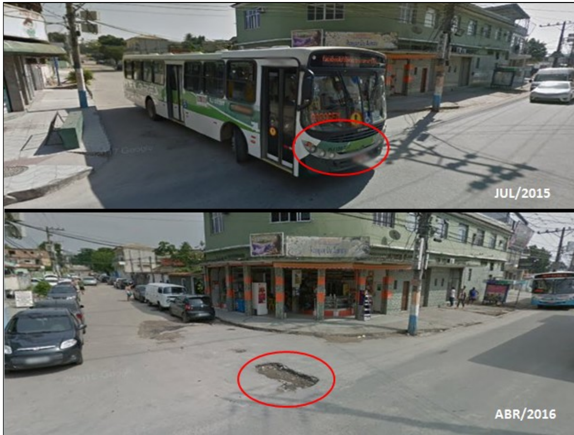
Figura 40: Caso de logradouro com buraco
