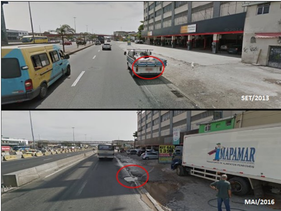
Figura 44: Caso de logradouro com buraco
