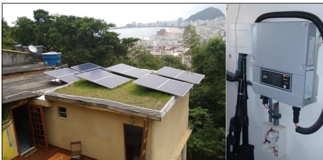
Figura 30. Placas solares e teto verde na laje da Estrelas da Babilônia (esq.) e inversor digital ligado à rede de distribuição de energia elétrica da Light (dir.) (acervo do autor)
