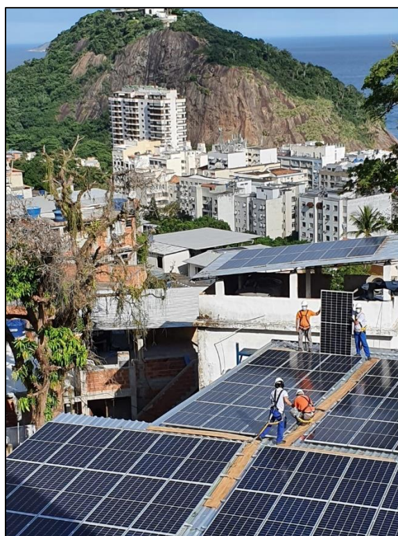
Figura 52. Usina da Cooperativa (em primeiro plano) com a instalação na Escolinha (ao fundo), 18/02/2021 (Acervo Revolusolar)
